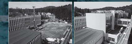
Rozwój infrastruktury - powstanie nowego budynku C Wydziału Ekonomicznego, marzec 2012 r. i kwiecień 2013 r.
